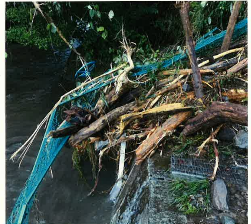
令和元年台風第19号による取水門の被災状況 (神奈川県南足柄市(約6,900戸断水))
